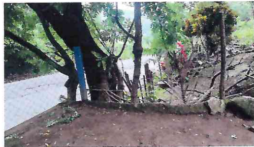
Foto 6: Muro perimetral que se cayó por deterioro.
