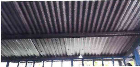
Foto1: Láminas en mal estado por lluvia
