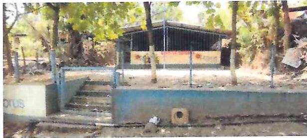
Foto 3: Muro perimetral dañado por las lluvias
