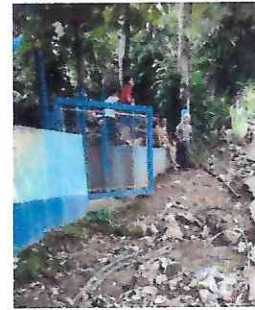
Foto 4: Muro perimetral dañado por las fuertes lluvias y el agua de la carretera
