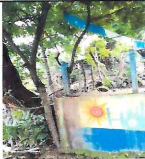
Foto 5: muro perimetral en mal estado por lluvias
