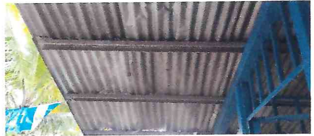
Foto 2: Láminas dañadas por el viento y lluvia
